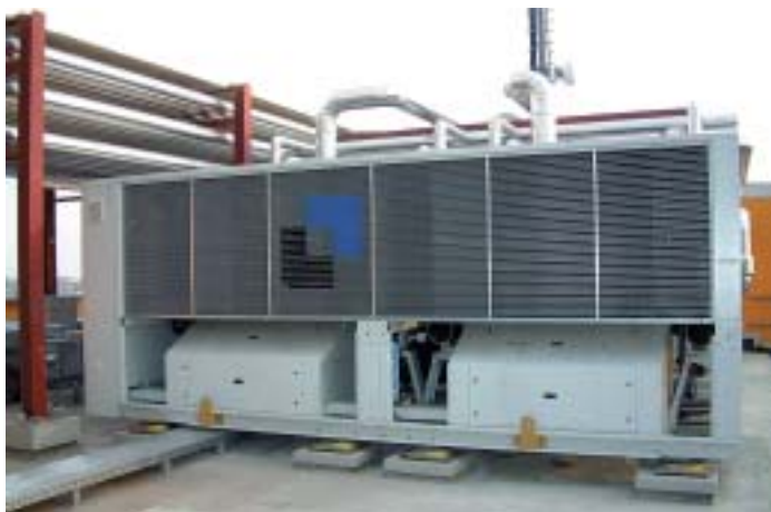
Per l'edificio A la produzione di acqua refrigerata è assicurata da due gruppi con condensazione ad aria con potenza di 595 kW cadauno, installati sulla copertura
