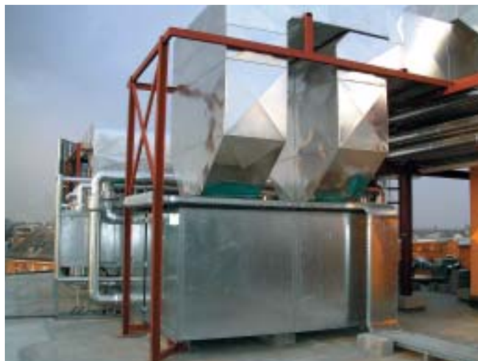
Le unità di trattamento dell'aria sono dotate di sezioni filtranti, ventilatori di mandata e di ripresa, recuperatori di calore a batterie accoppiate, batterie di riscaldamento e di raffreddamento, sezione di umidificazione a vapore prodotto da apparecchi ad elettrodi immersi
