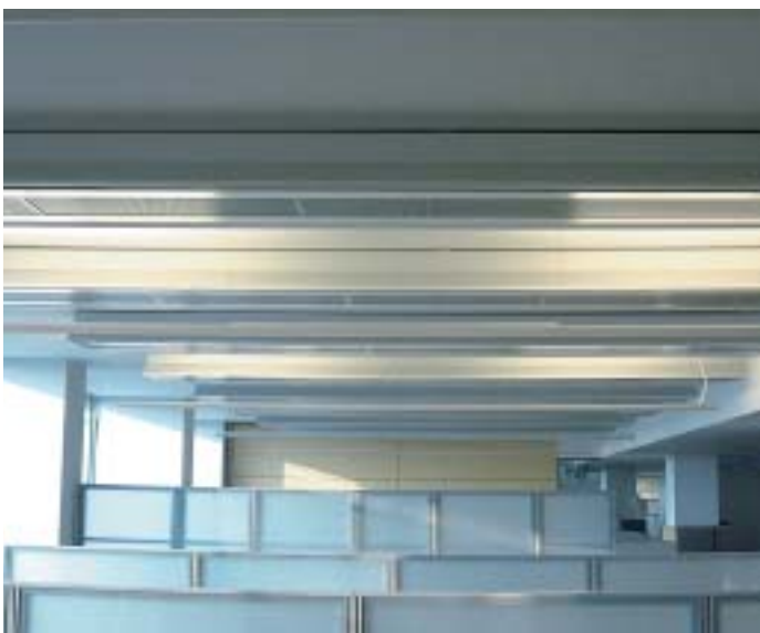
La climatizzazione degli uffici dell'edificio A è realizzata mediante travi fredde ad induzione con aria primaria, montate a vista e dotate di una cover di mascheratura disegnata ad hoc
