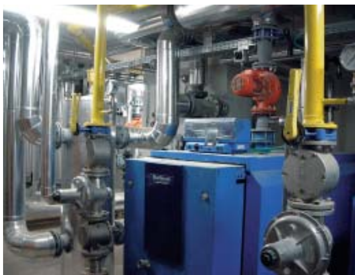
La centrale termica dell'edificio A è dotata di due caldaie a gas a bassa emissione di NOx della potenza di 530 kW cadauna
